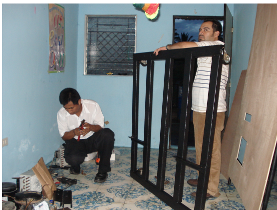
Fotografía 8: Pintura de base metálica
