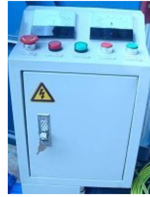
Armario de control eléctrico
