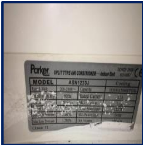
Placa de aire acondicionado
