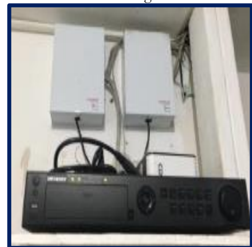
Sistema de cámaras
