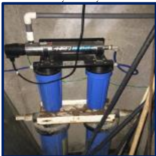
Equipo de filtración
