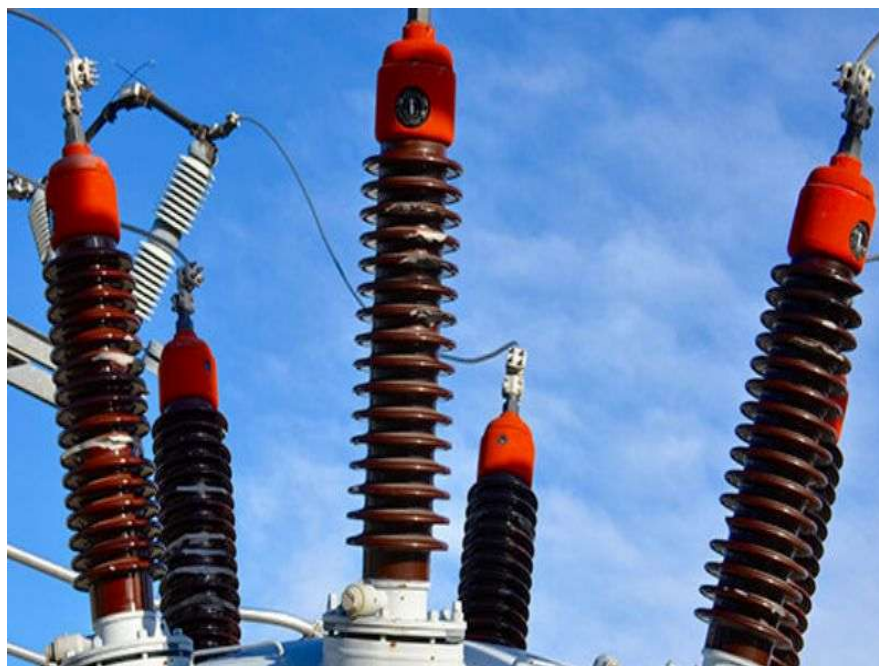
Figura 2.1 Diferentes tipos de aisladores utilizados en sistemas de transmisión de energía (INMR, 2022).
