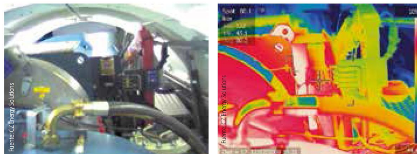
Fig. 2.2. Inspección termográfica del interior de una turbina eólica [2].
