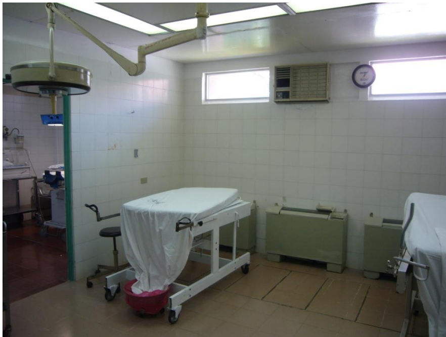
Figura 6.13: Climatización dentro de la sala de partos y del tocoquirófano.
