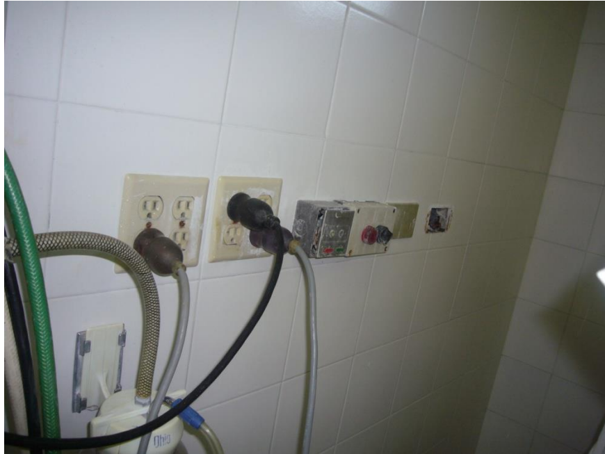
Figura 6.10: Tomacorrientes del Tocoquirófano.
