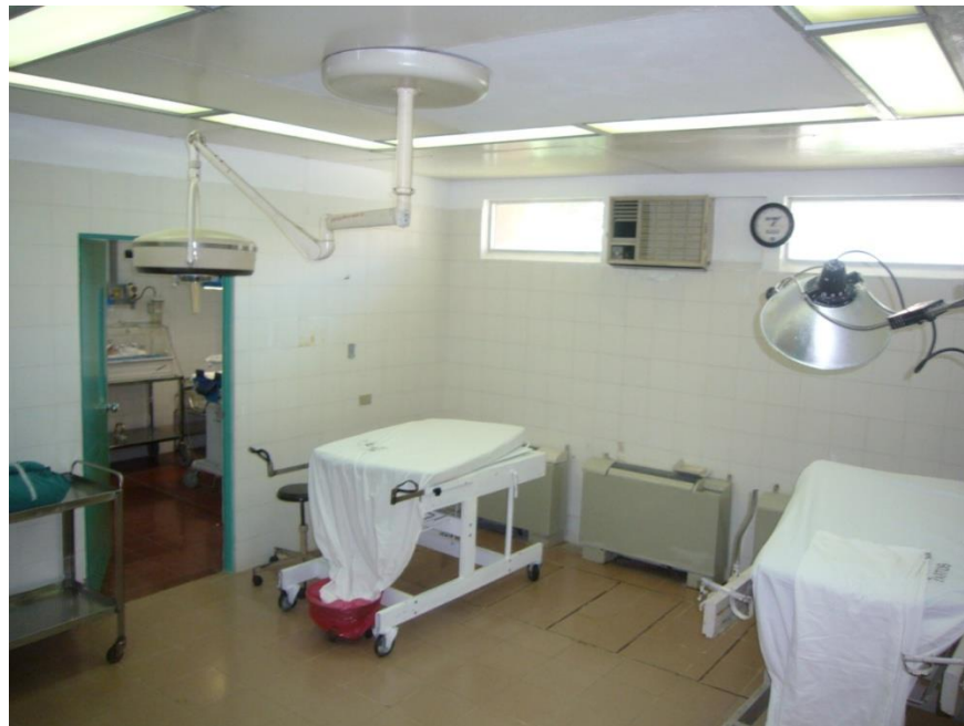
Figura 6.6: Paredes de cerámica con juntas de Sala de Parto y el Toco Quirófano. Las paredes de la sala de parto y el tocoquirófano cuentan con las siguientes características:
