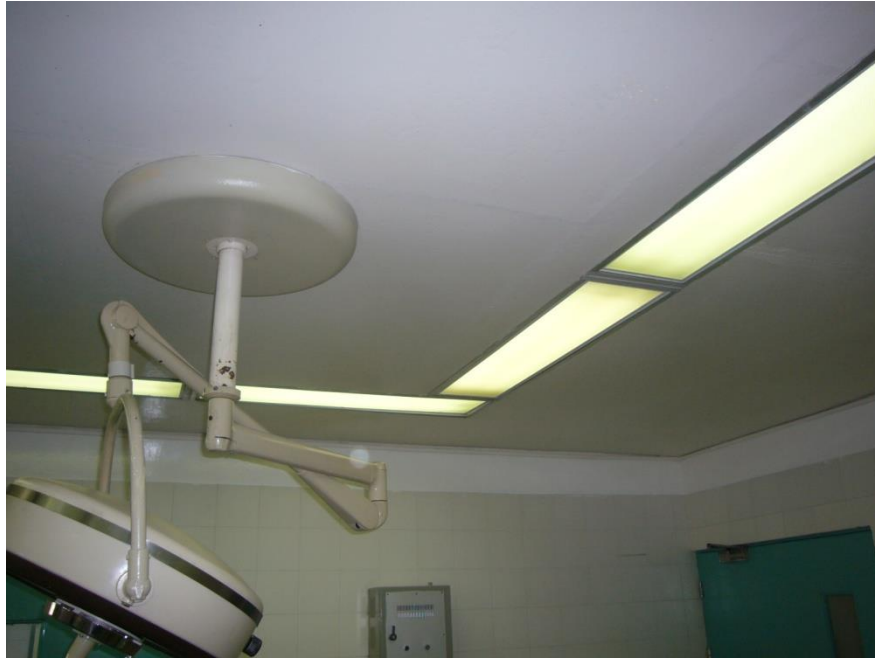
Figura 6.11: Luminarias dentro de la sala de partos y el tocoquirófano.
