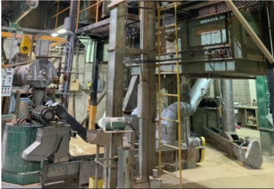
Ilustración 13. Área de extrusoras, utilizados en Balanceados S.A. de C.V. Fuente: Equipos instalados en Balanceados S.A. de C.V.
