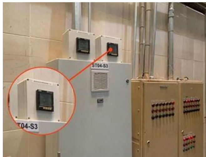
Ilustración 25. Medidor energético instalado en panel eléctrico de equipos de producción.
