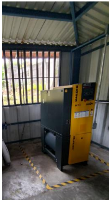
Figura 1.28 Fotografía interna del Cuarto/Bodega del Compresor y Filtro Coalescente Fuente: Fotografía tomada por el autor
