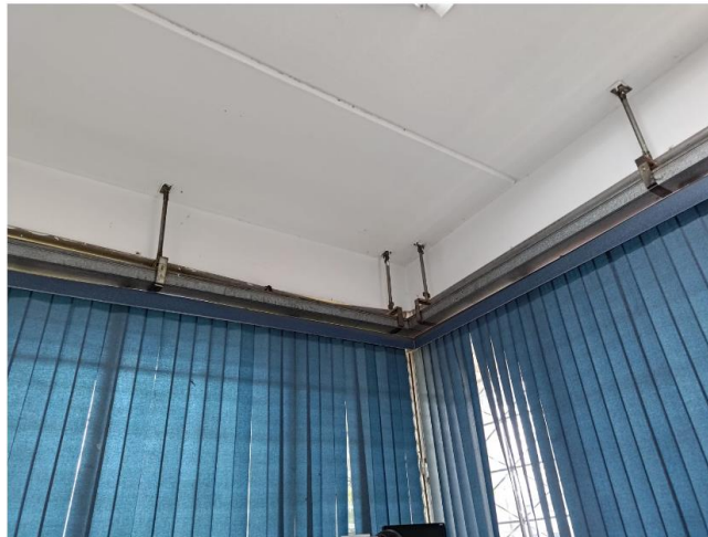
Figura 4.2. Fotografía de zonas con suciedad dentro del Almacén Bodega – Techo y Canaletas Fuente: Fotografía tomadas por el autor
