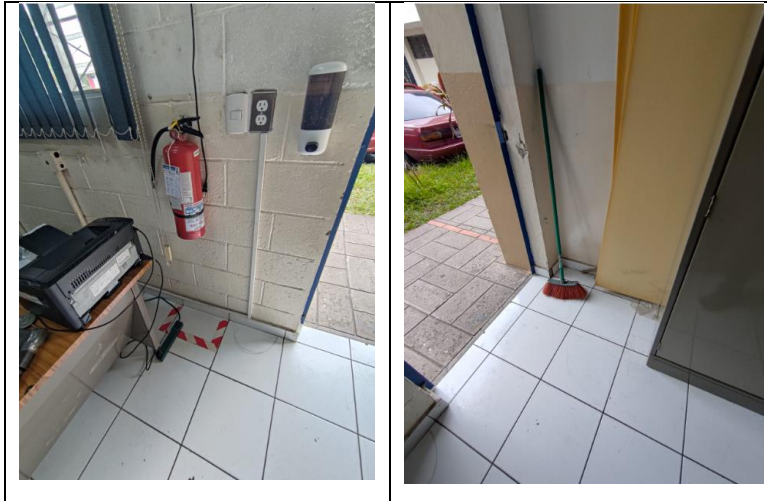
Figura 4.3. Fotografías de zonas con suciedad dentro del Almacén Bodega Fuente: Fotografías tomadas por el autor
