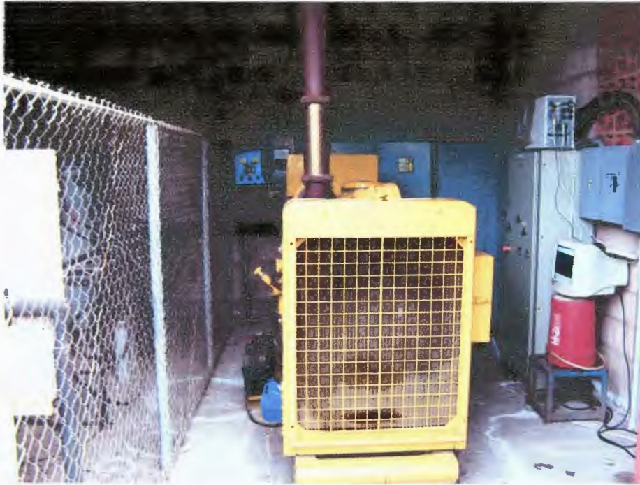
A9. Vista de la distribución de espacios en el cuarto de Subestación #2
