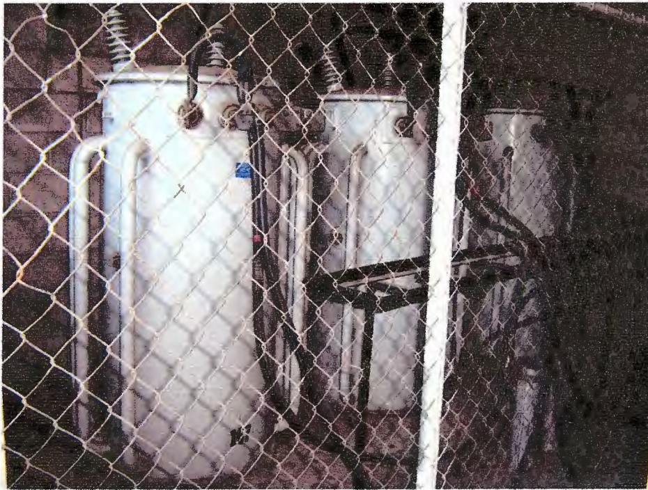
A7. Subestación 501 KVA a la cual el medidor CVMk censa sus datos
