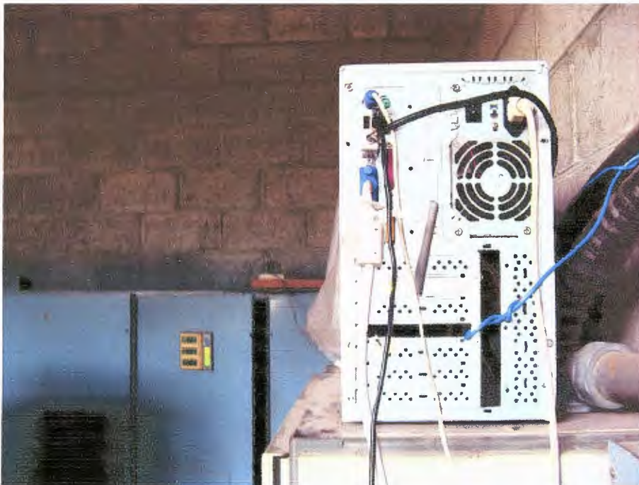
A6. Vista del CPU utilizado como servidor en el cual se puede observar la antena de la tarjeta de Red inalámbrica.
