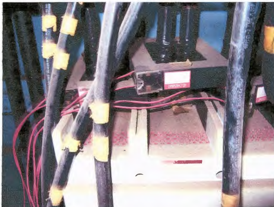
A4. Vista de los Transformadores de corriente (Donas) dentro del panel
