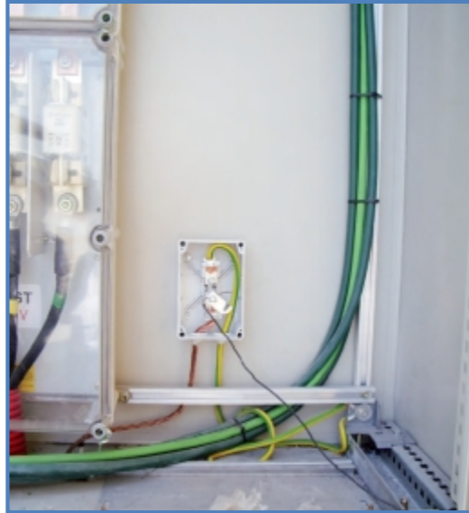
Figura 4. 27 Polarización de los tableros de la planta
