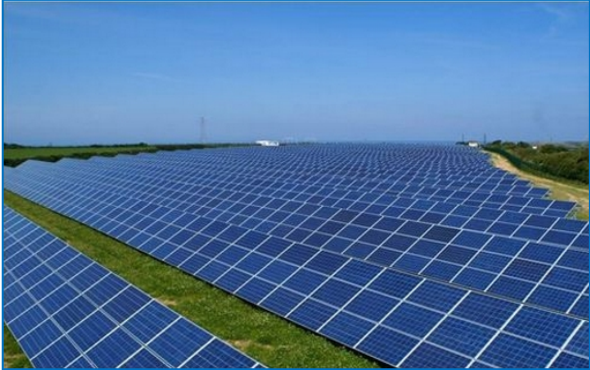
Figura 4. 33 Distribución de la planta fotovoltaica 5 MWe(obtenida de la web)
