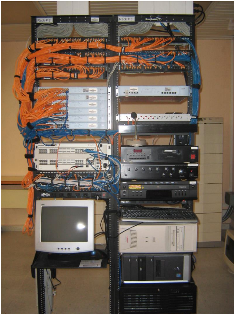
Equipos en el centro de comando tecnológico del sistema.
