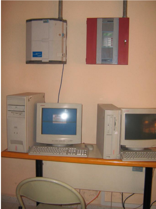
Centro de control con las computadoras y los equipos adicionales para la conversión de señales previo a su ingreso al control central del sistema.
