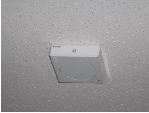
Sensor de humo interconectado al control principal.
