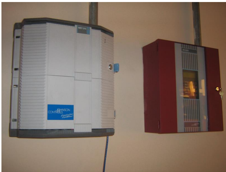
Elementos de control para la conversión de señales previo a su ingreso al control del sistema.
