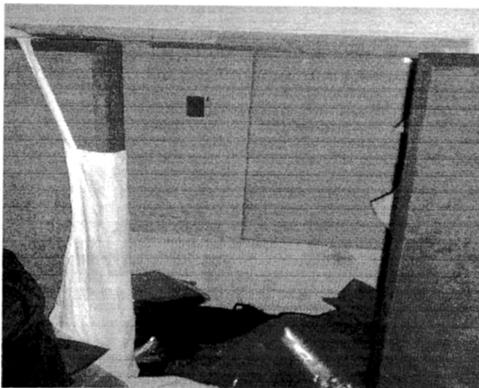
Figura 9: Subtablero que ha sido tomado como pequeña bodega.
