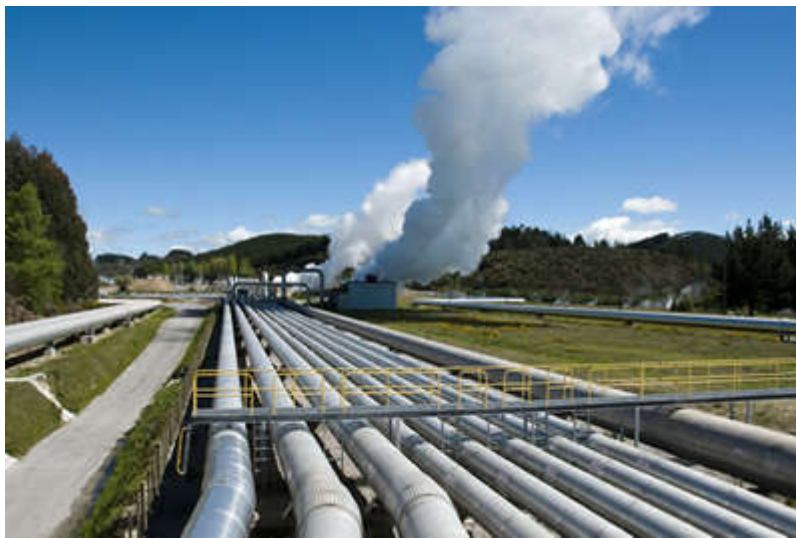
Figura 2: Tuberías de acarreo en campo (GNS Science, 2015)
