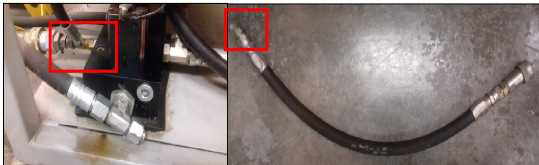
Figura 3.11 Acoples con fisura.
