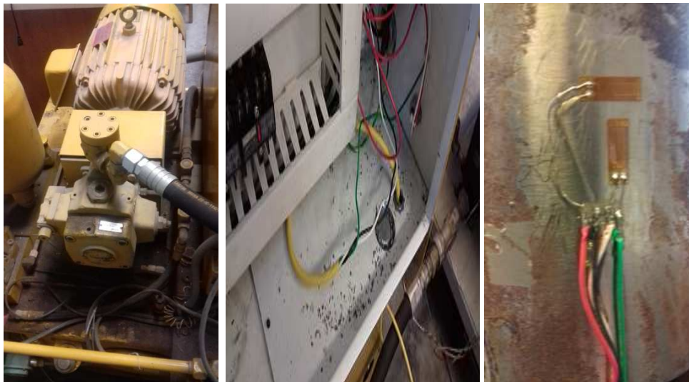
Figura 3.12 Condiciones iniciales en que se encontraba el equipo.
