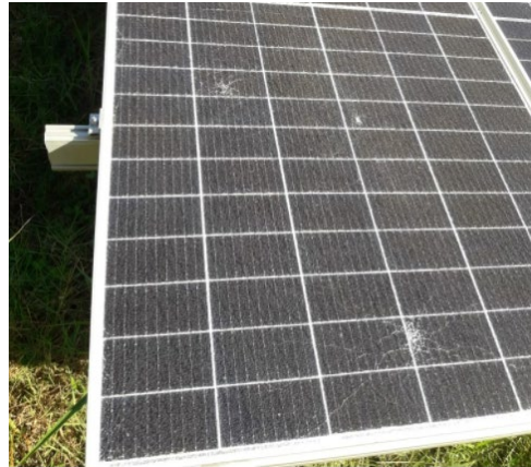
Figura 10 Módulo con fractura
