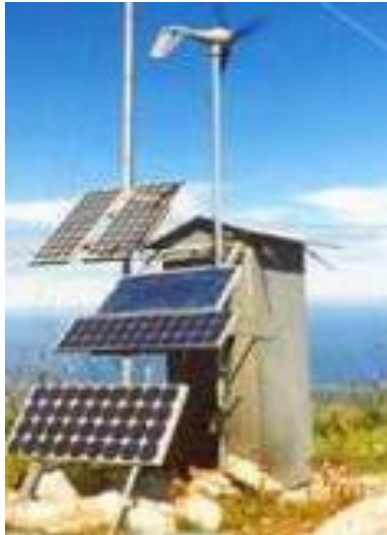
Fig. 3.1 Sistema híbrido solar – eólica. Utilizado para recopilar dato de las velocidades de viento.
