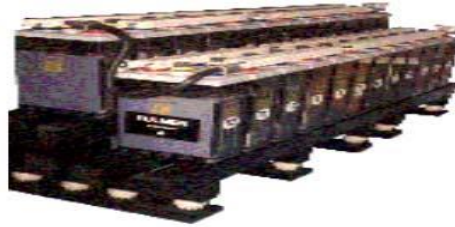
Figura 4.9. Banco de baterías
