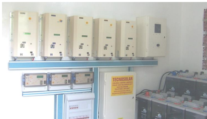
Figura 5.2 Tablero de control y protección
