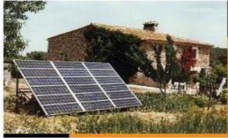
Figura 4.1 Paneles solares tipo suelo
