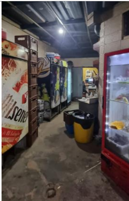
Camaras refrigerantes para bebidas frías
