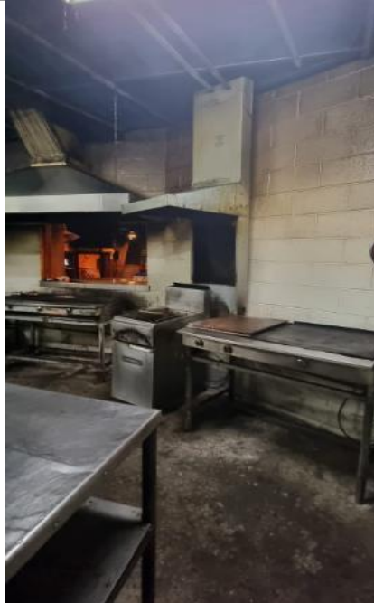
Área de cocina y extractor sin uso
