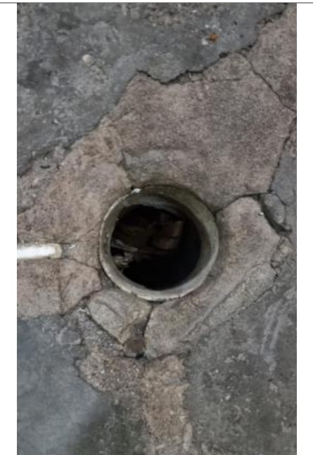
Desagüe sin cedazo del piso del área de cocina
