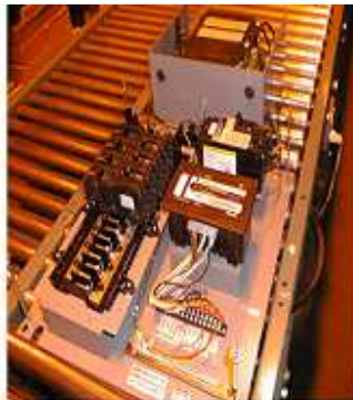
Figura 4.3 Vista Interna Transformador de Aislamiento
