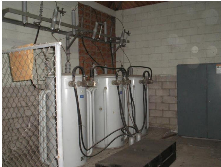
Figura 3. Subestación de Eléctrica.
