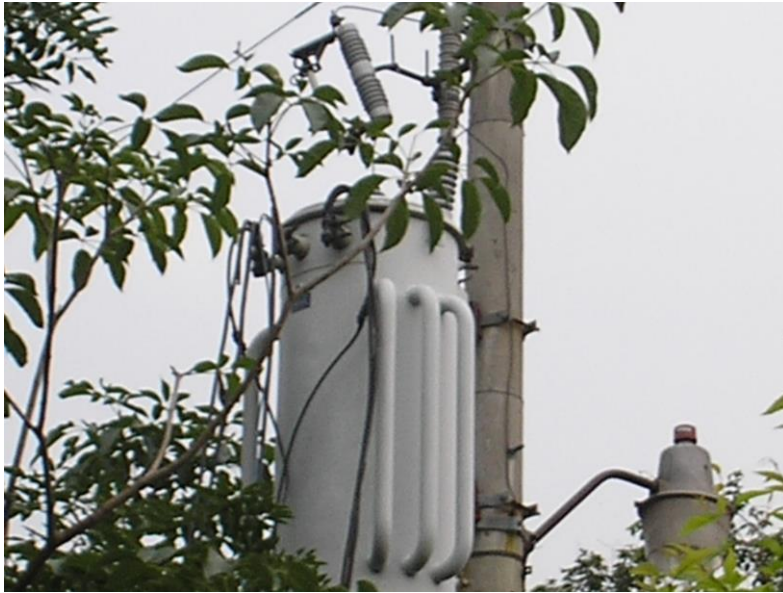
Figura 5. Subestación Aérea Monofásica.
