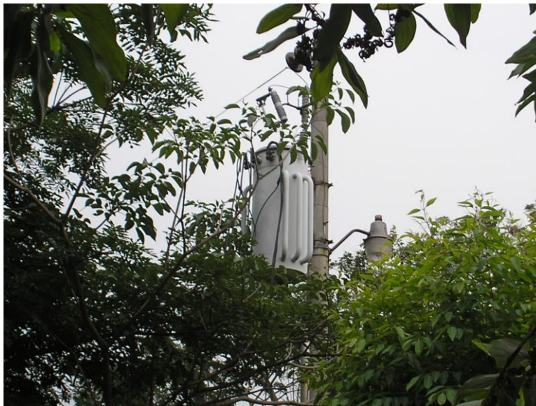
Figura 6. Subestación Aérea Monofásica.
