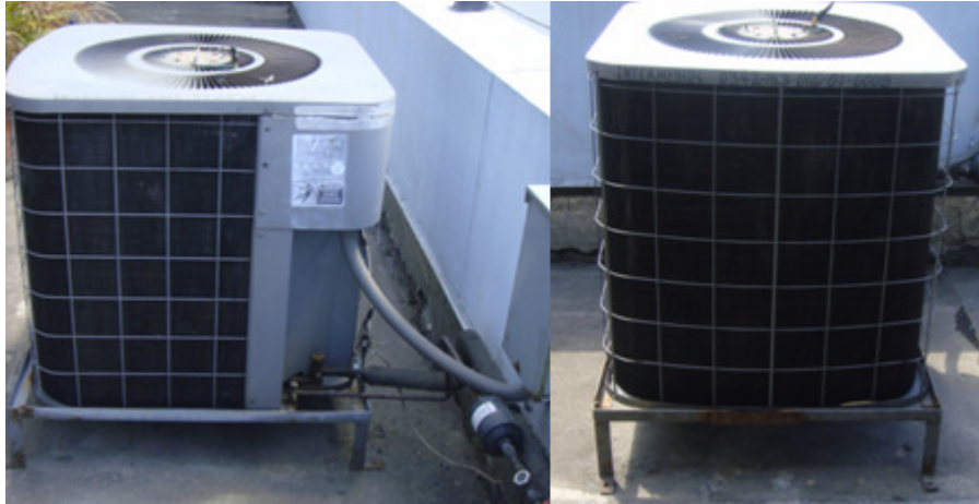
Figura 4.6.2.3-5 – Sistema de Aire Acondicionado.
