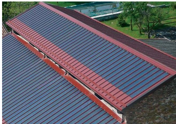
Figura 3.38 Cubierta inclinada con módulos fotovoltaicos flexibles
