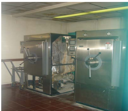
Imagen 7.34 Estado actual de los equipos
