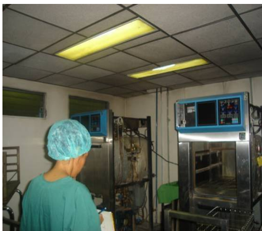
Imagen 7.33 Iluminación deficiente. Área de Esterilización
