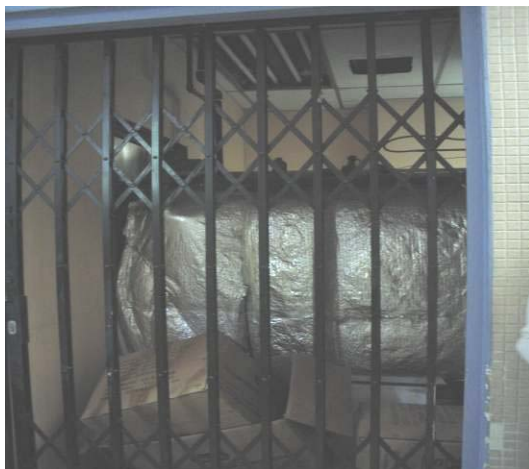
Imagen 7.14 Acceso a los esterilizadores para el Personal de Mantenimiento
