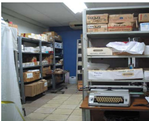
Imagen 7.50 Piso dañado área de bodega de insumos médicos, ubicado dentro de la Oficina de la Jefatura.
