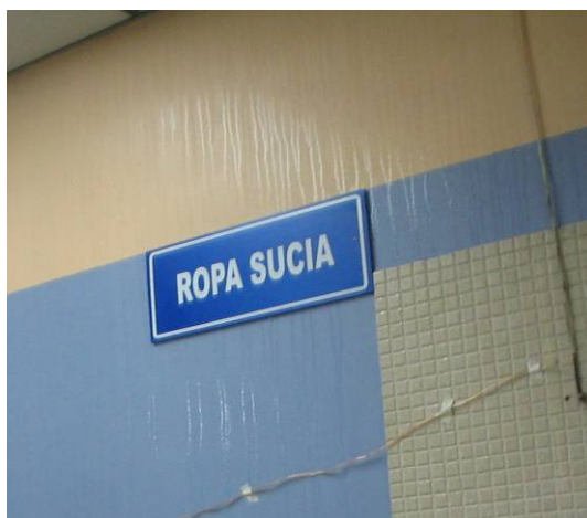
Imagen 7.13 Paredes afectadas por filtraciones de agua.
