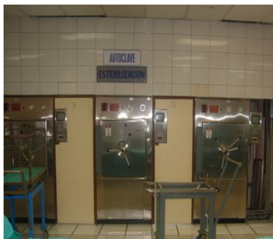
Imagen 7.26 Estado Actual de los Equipos
