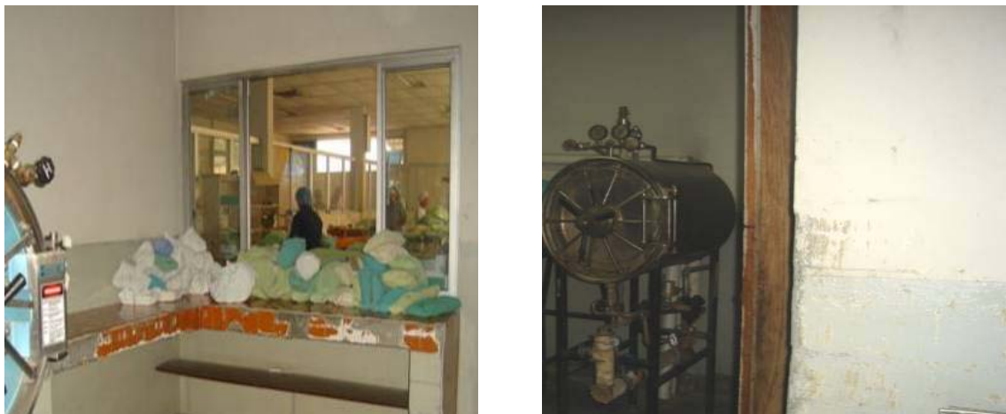
Imagen 7.5 Daños en paredes y estructuras
