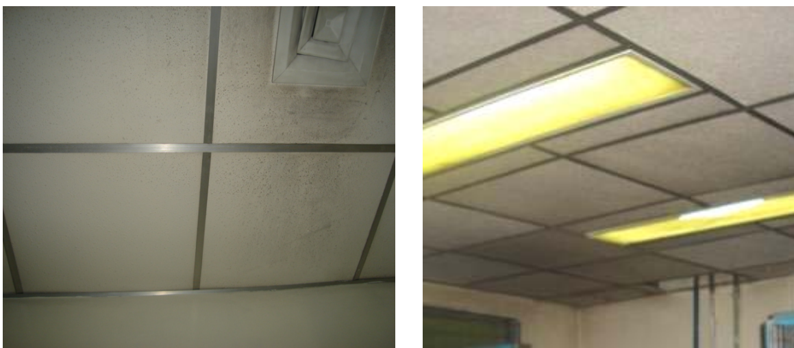
Imagen 7.31 Cielo falso dañado debido a la humedad.
