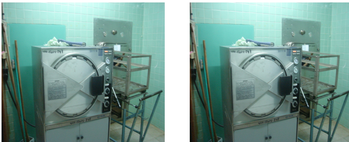
Imagen 7.40 Estado actual de los equipos de la Central
