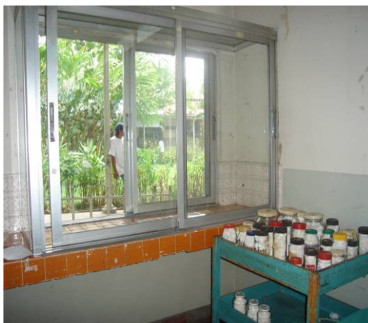
Imagen 7.3 Ventanilla de despacho de material estéril (Vista desde el interior de la Central)
