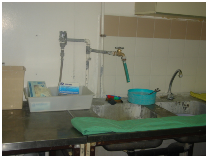
Imagen 7.32 Los lavabos se encuentran oxidados y manchados.
