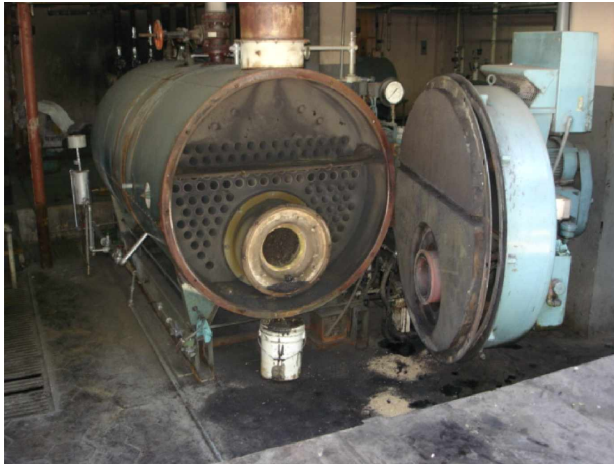
Fotografía 9. Caldera en mantenimiento
