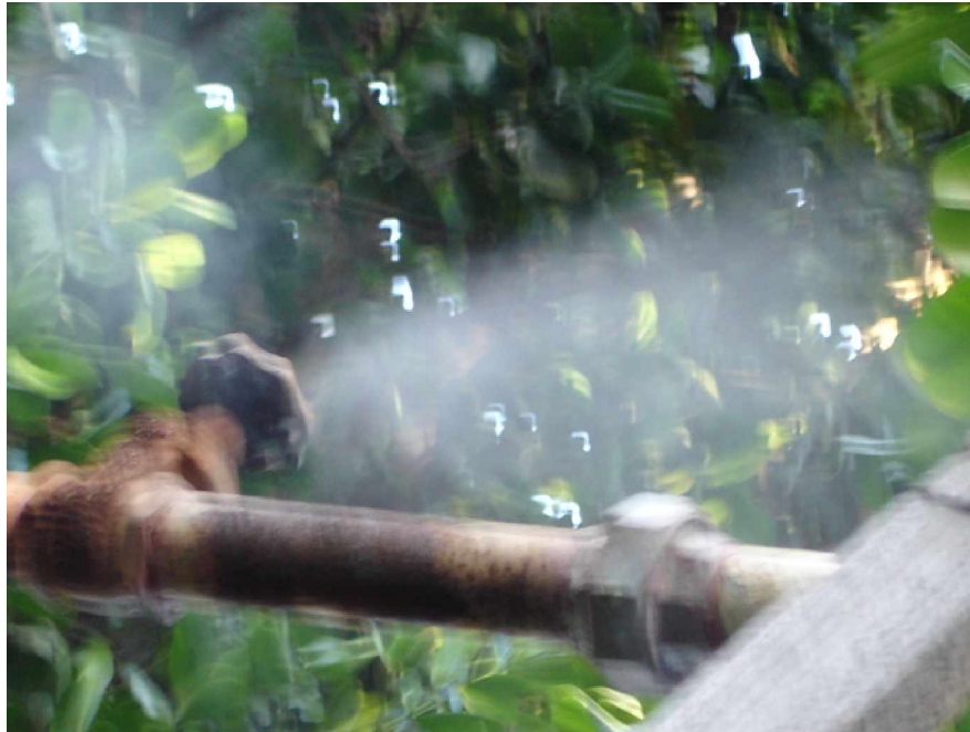
Fotografía 1. Muestra las numerosas fugas de vapor que se encuentran en el sistema de vapor
