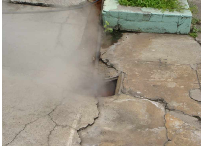
Figura 2.4. Descarga de condensado a la alcantarilla, proveniente de la Central de Equipos.
