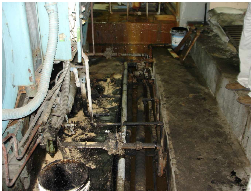
Fotografía 2. Derrames de combustible (fuel Oil) en la sala de maquinas.
