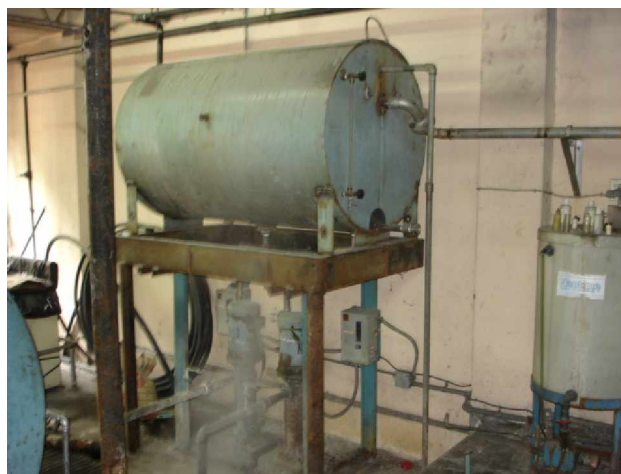
Figura 2.3. Tanque de condensado, recibe condensado de Cocina y Lavandería
