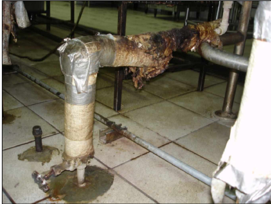
Fotografía 3. Condiciones deterioradas del aislamiento.
