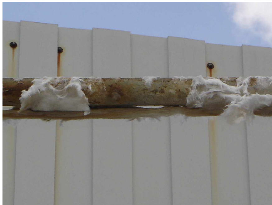
Fotografía 4. Condiciones deterioradas del aislamiento
