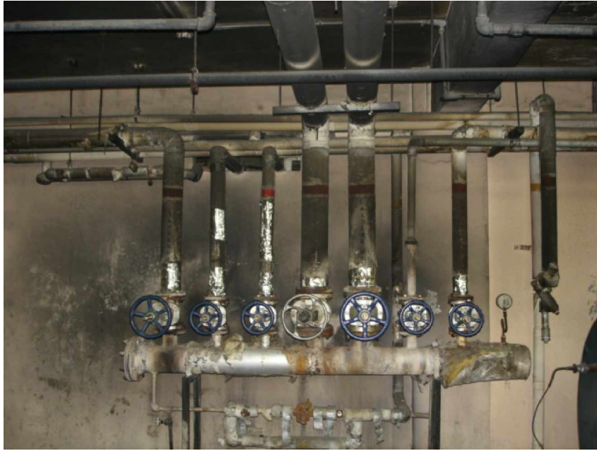
Fotografía 5. Cabezal de distribución sin aislamiento.
