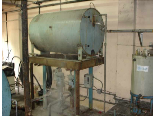
Figura 1.17. Tanque de condensado.
