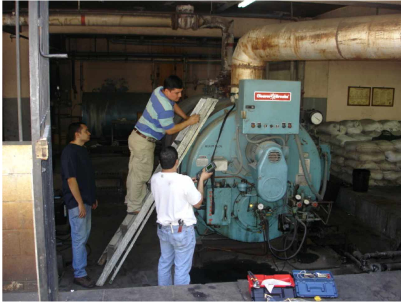
Fotografía 11. Análisis de gases de combustión a la caldera.
