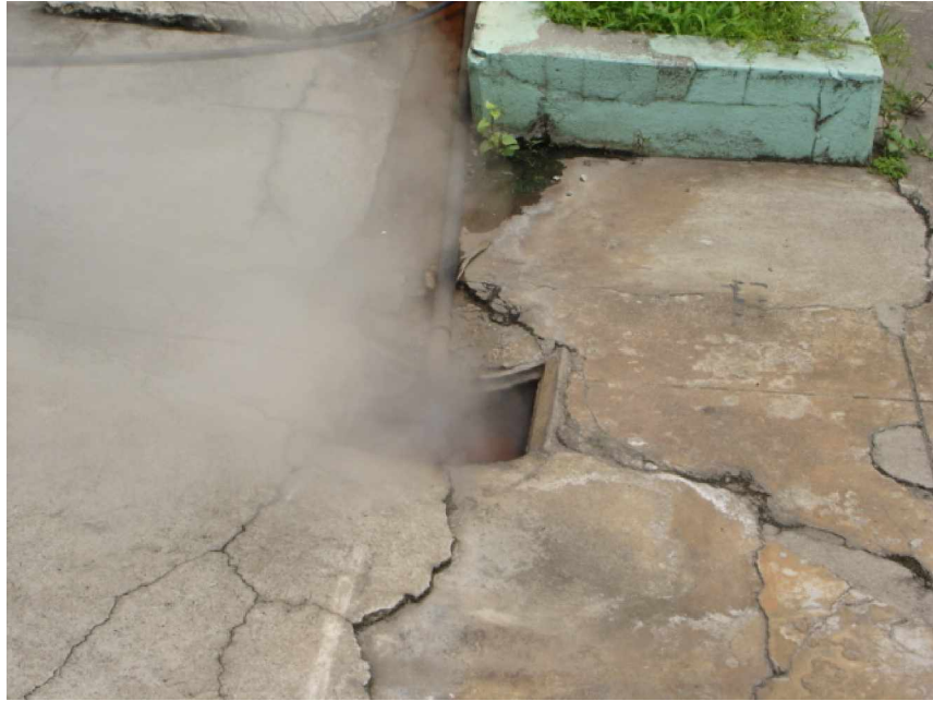
Fotografía 7. Descarga de vapor intermitente al drenaje (Aproximadamente cada 10 segundos).
