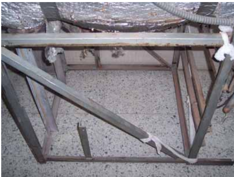
Figura 4.36. Se observa la falta de tuberías para el equipo esterilizador.
