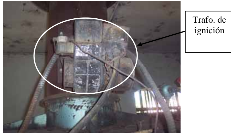
Figura 3.34. Transformador Cámara Secundaria.
