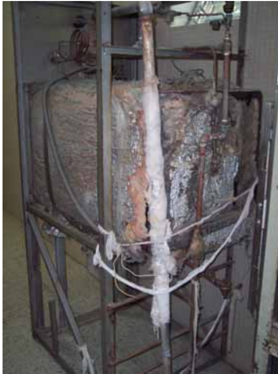
Figura 4.37. Se observan el estado de corrosión del sistema de tuberías del equipo esterilizador.
