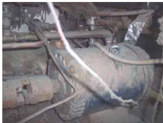
Figura 3.15. Motor Trifásico Generador de Vacío.
