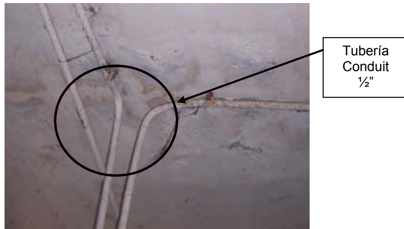
Figura 3.29. Instalaciones Eléctricas Cuarto de Incineración.
