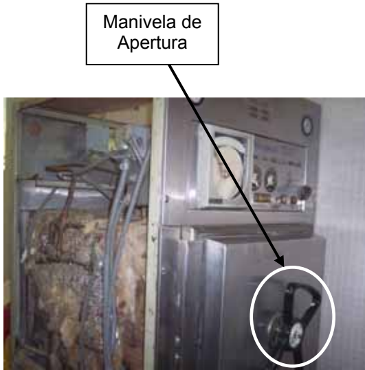
Figura 3.1. Compuerta Area Gris.
