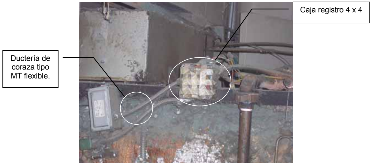
Figura 3.14. Condiciones de Instalaciones Eléctricas.
