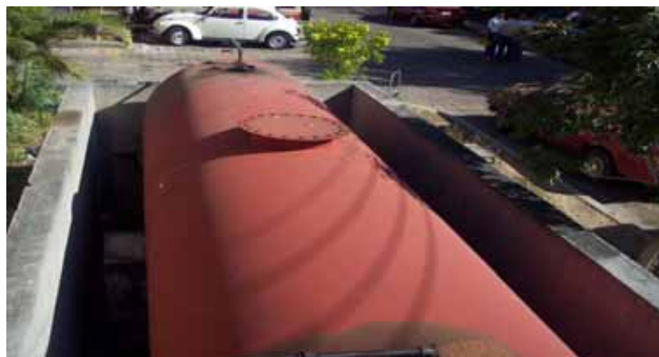
Figura 3.36. Tanque de Almacenamiento para Combustible Diesel.
