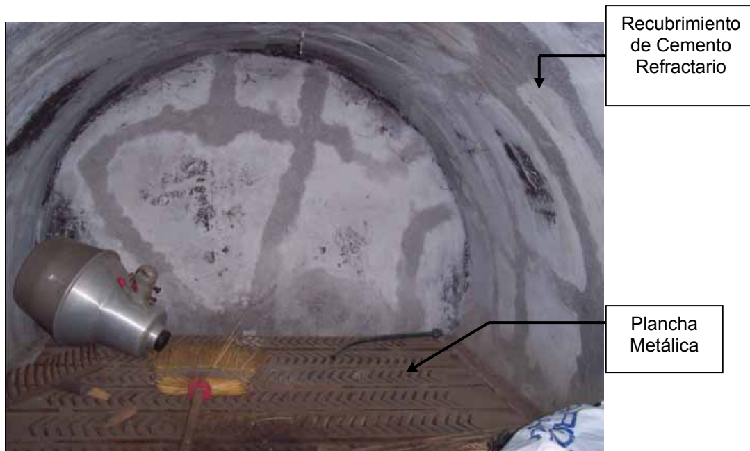
Figura 3.24. Interior del Incinerador
