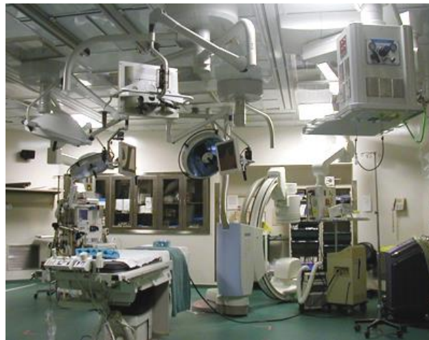
Figura 2-3: Salas de Operaciones con sistemas de video y monitoreo
