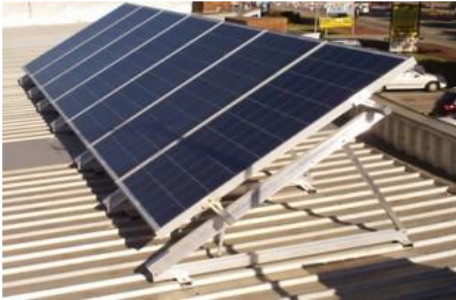
Figura 2.10 Módulos fotovoltaicos montados en estructura metálica con una inclinación determinada en techo plano 31 .
