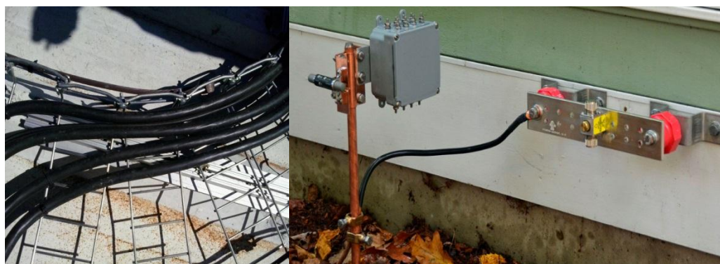
Fig. 4.6 Conductor puesta a tierra y varilla puesta a tierra
