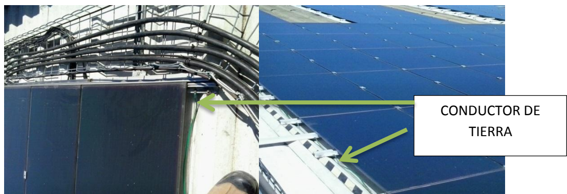
Fig. 4.5 Conductor de tierra de una planta fotovoltaica
