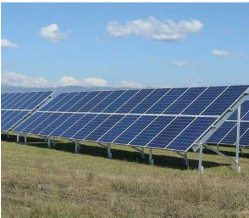
Figura 2.13. Módulos fotovoltaicos instalados en el suelo 35 .
