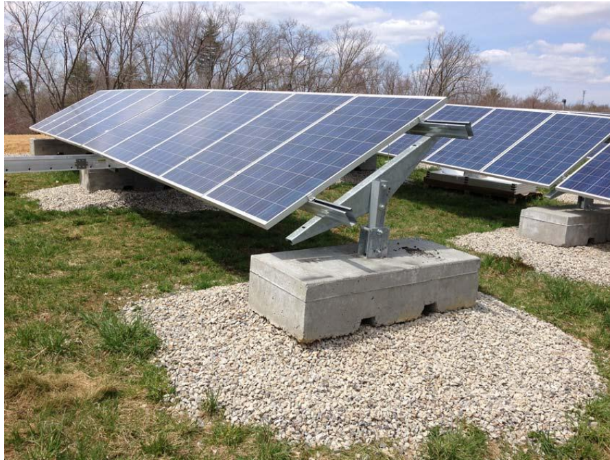
Figura 2.11 Módulos fotovoltaicos montados en estructura metálica lastrada 33 .
