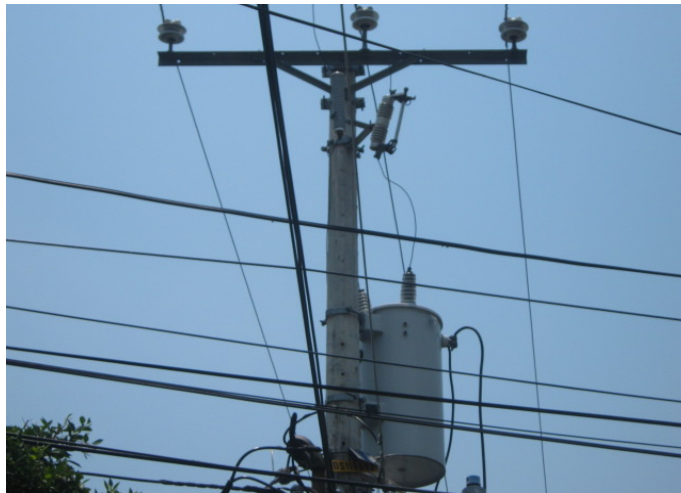
FIGURA 1.8. Subestación de 100 kVA de Administración superior.
