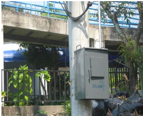
FIGURA 1.23. Gabinete del medidor de la subestación.
