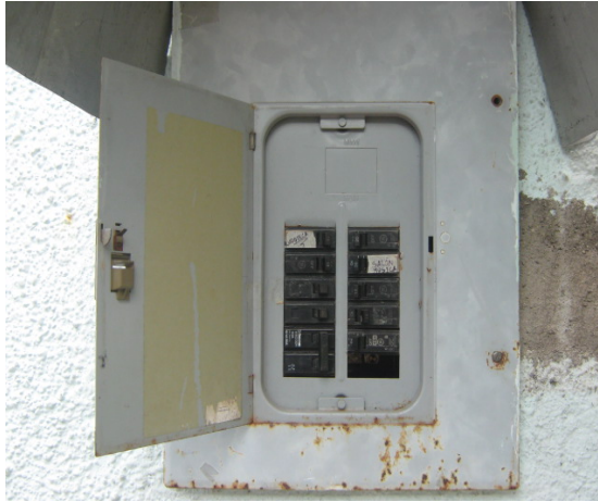
FIGURA 1.19 Tablero del Edificio B
