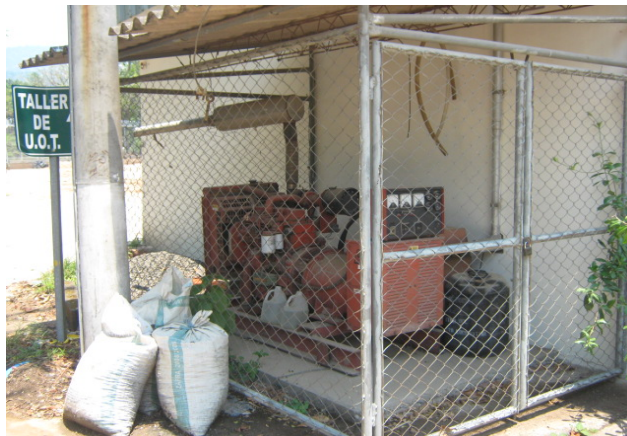
FIGURA 1.39. Ubicación del grupo electrógeno
