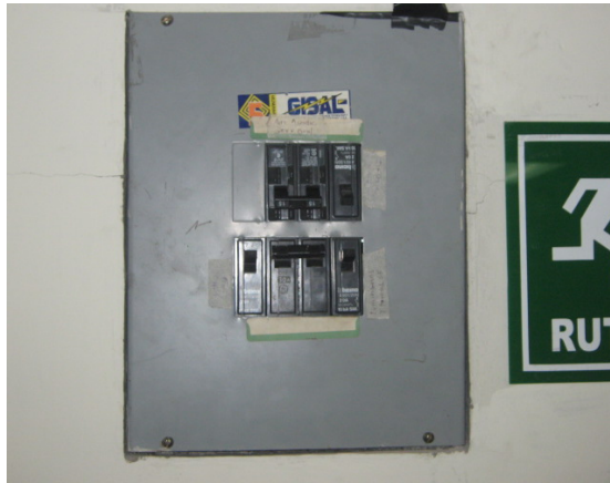
FIGURA 1.15 Tablero de servicios generales.
