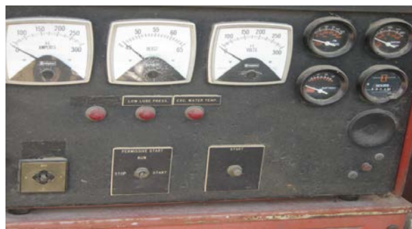
FIGURA 1.40. Tablero de indicadores y operación del Grupo Electrónico.
