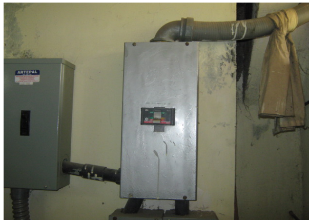
FIGURA 1.28. Protección principal de los subtableros.
