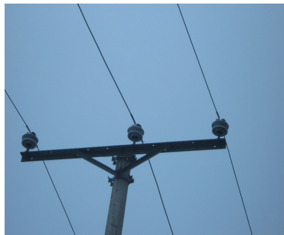
FIGURA 1.6. Estructura para tendido en MT.
