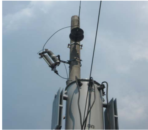
FIGURA 1.21 Estructura primaria de la subestación de 100 kVA.
