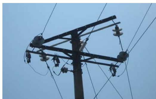
FIGURA 1.2. Punto de entrega de la distribuidora
