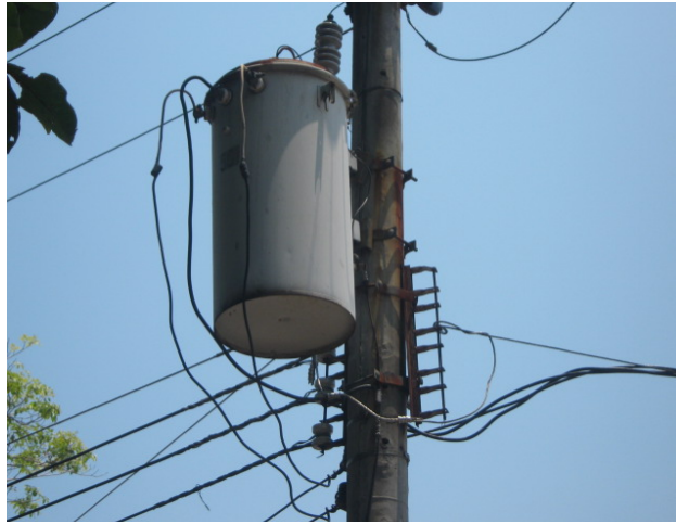
FIGURA 1.33. Subestación monofásica de 50 kVA.
