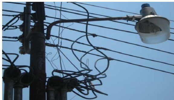
FIGURA 1.44. Acometidas de entrada y salida de transferencia.
