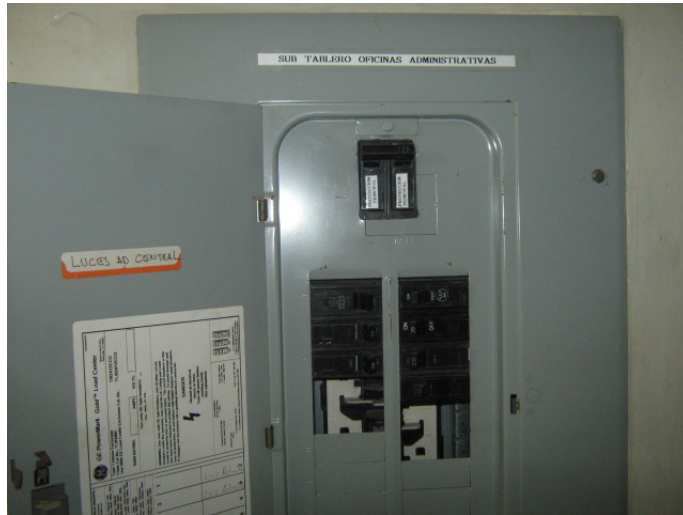
FIGURA 1.14 Tablero de Oficinas Administrativas.
