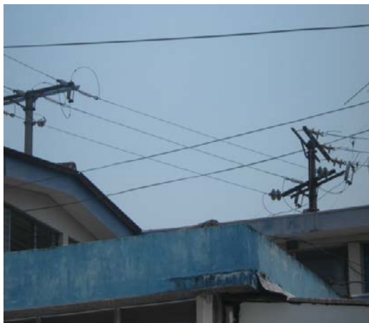
FIGURA 1.5. Vista de las estructuras entrega y recibo del servicio en MT.
