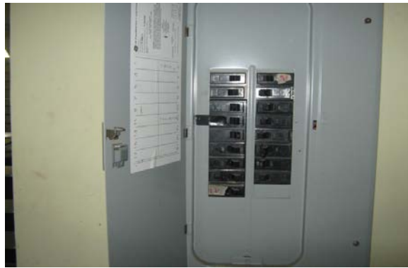
FIGURA 1.32. Tablero de cargas monofásicas.
