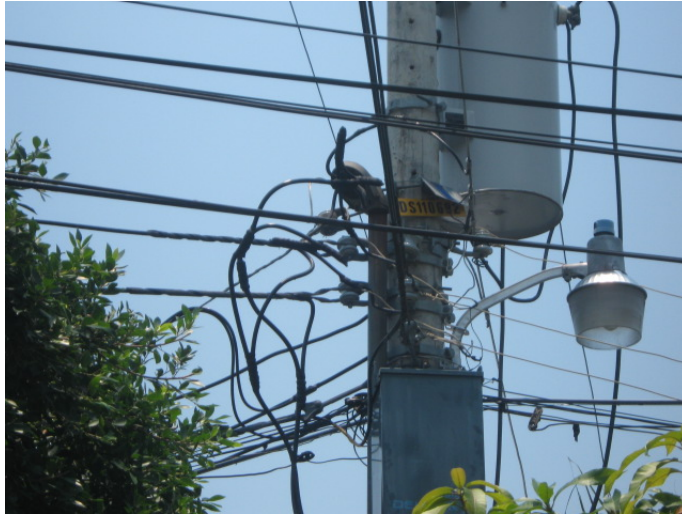
FIGURA 1.9. Bajada del lado secundario de la subestación y empalmes para formar las acometidas aéreas y subterránea.
