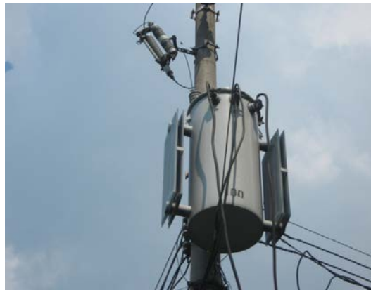
FIGURA 1.22 SUBESTACIÓN DE 100 kVA
