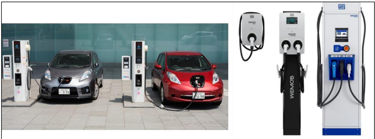
Figura 10. Ejemplo de infraestructura de carga para vehículos eléctricos.
