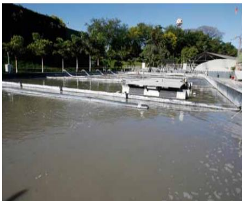
Ilustración 11 Planta de tratamiento de Aguas Residual
