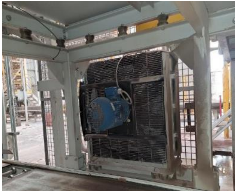
Figura 1.13. Sistema de enfriamiento
