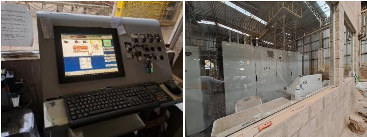
Figura 1.30 Cabina de control
