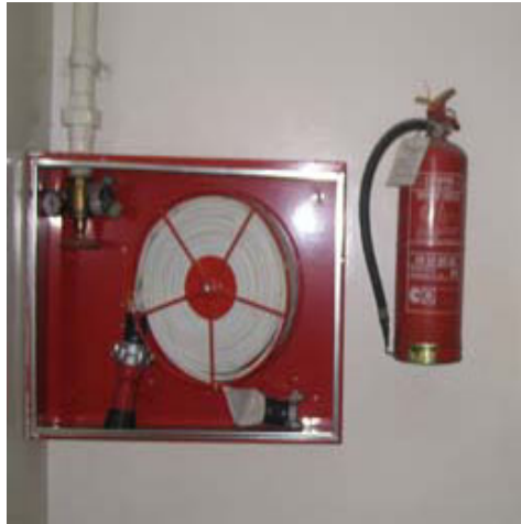
Fig. A-12 Equipo contra incendios
