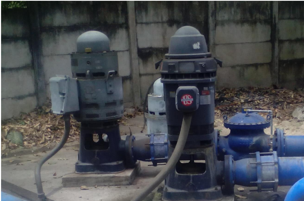
Figura 17. Equipos de bombeo en tanque cisterna. (Autoría propia).
