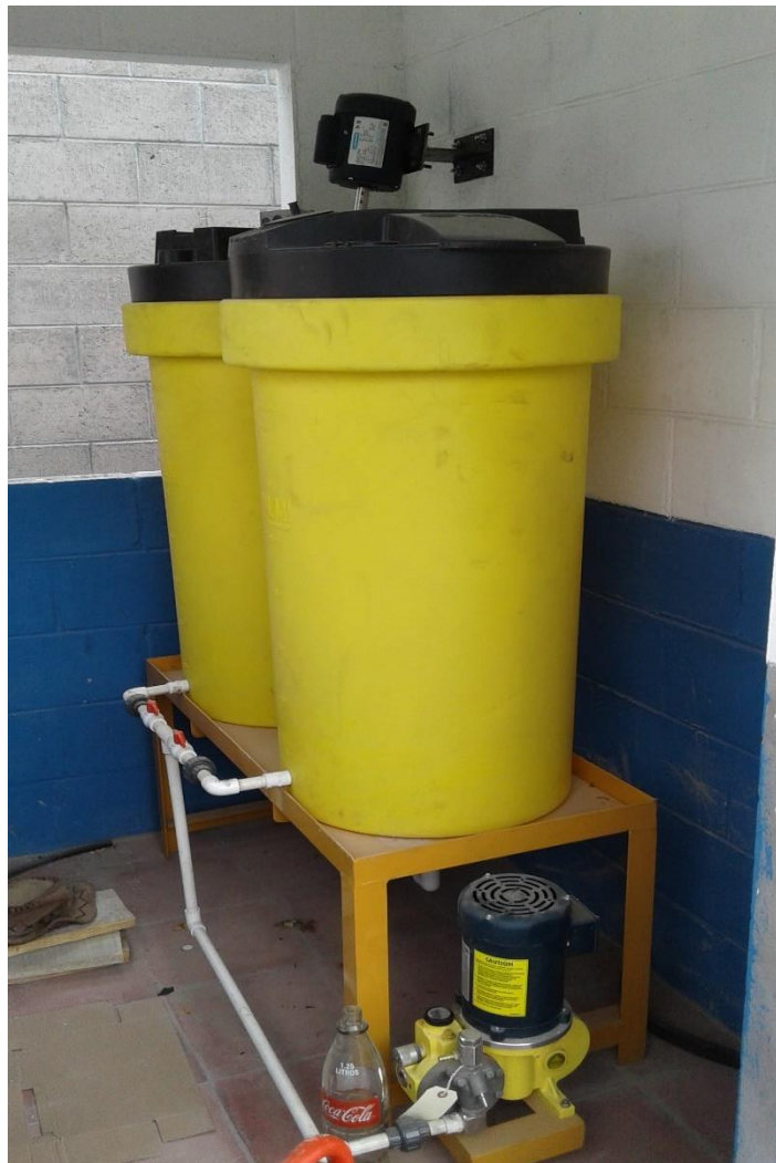
Figura 16. Aparato hipoclorador. (Autoría propia).
