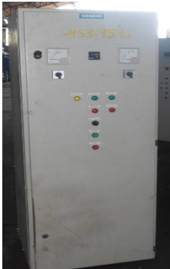
Figura 11. Gabinete de protección y control para motor de 200 HP. (Autoría propia).
