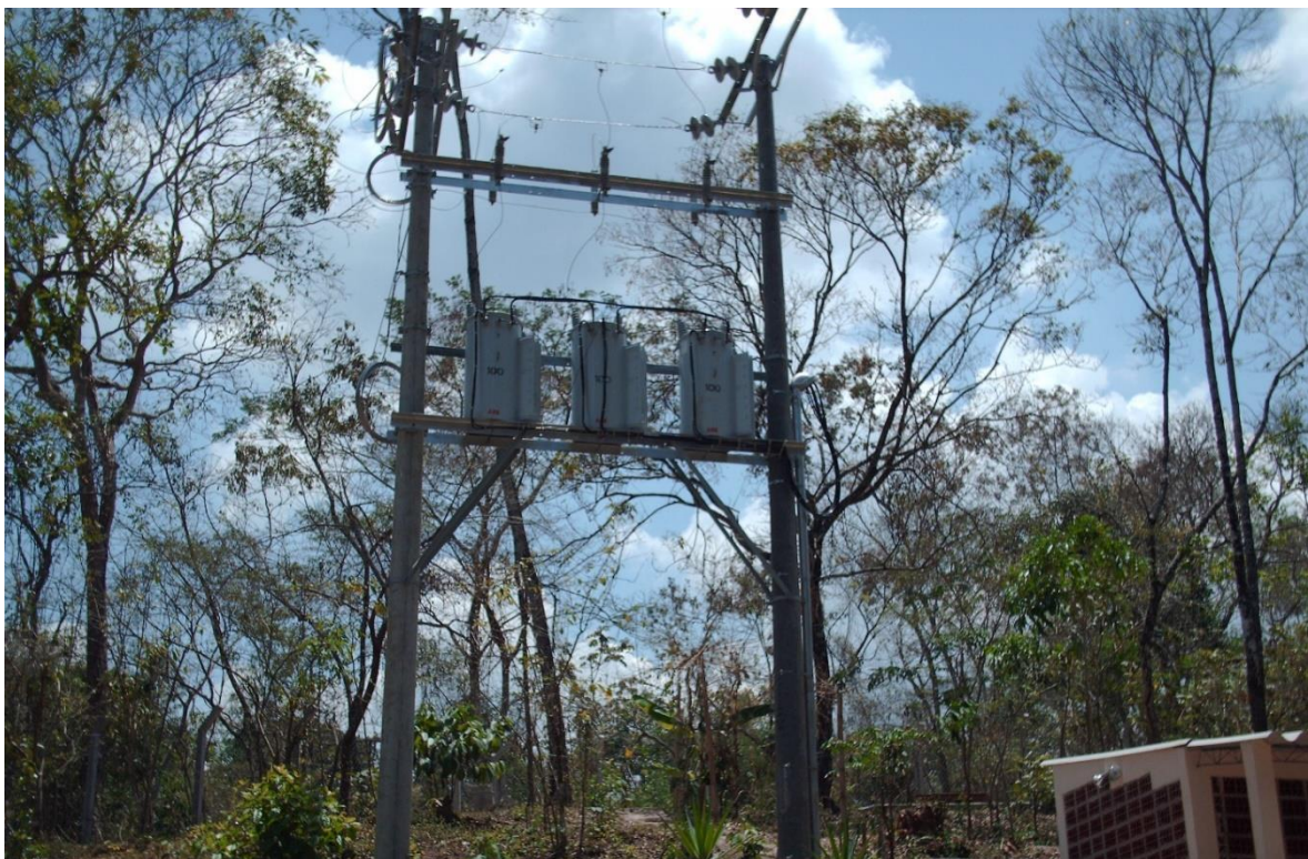
Figura 10. Subestación eléctrica de 300 KVA. (Autoría propia).
